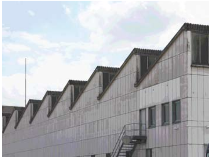
Ältere Industrie- und Gewerbeliegenschaften haben es schwer im Immobilienmarkt. Die Entwertung der Objekte schreitet mit den rascheren Innovationszyklen in der Produktion häufig schnell voran.
