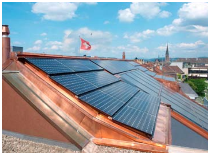
Ziegeldicht verlegte Solarmodule helfen mit, dass bei dieser Altbausanierung in Basel unter Beachtung des Stadtbildschutzes ein preisgekröntes Null-Wärmeenergie-Haus entstanden ist.
