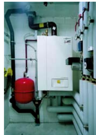
Links unten am Kessel der Kondensatablauf (in Trichter)
