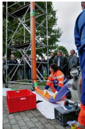
An den transparenten Rohrteilen konnte der Arbeitsfortschritt der Inversierung des Schlauchliners mitverfolgt werden...
