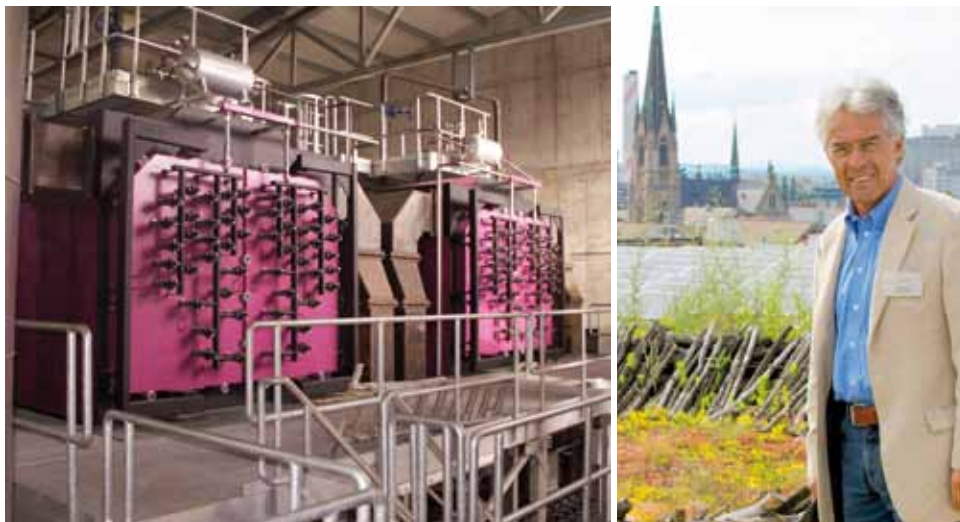
Im Bild: Ansicht zweier Biomasse-Rauchrohrkessel.
