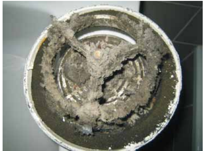
Badezimmer-Abluftventil: Raumseitig sauber, kanalseitig durch Verschmutzung in der Funktion behindert. Kontamination ist gegeben.
