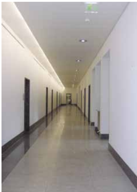
AXA Winterthur: LED-Korridorbeleuchtung.
