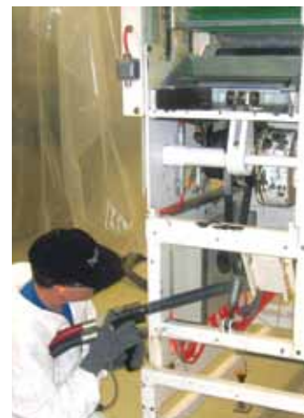
Keine Angst bei Kabeln, EL-Anschlüssen und Schaltschränken. TKIcepower ist eine Trockenreinigung.
