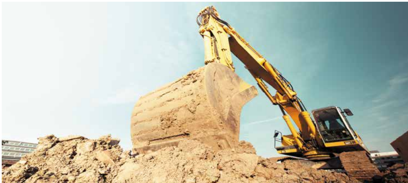
Die Abfolge von Vertragsabschluss und Baubeginn entscheidet über die Steuerpflicht (Foto: suze / photocase.com).
