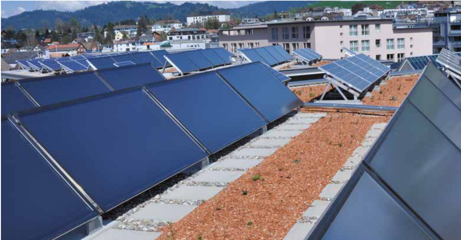
Minergie-P-Wohnsiedlung Grossmorgen, Einsiedeln: 195 m 2 Sonnenkollektoren decken 80 Prozent des gesamten Warmwasser- und Heizwärmebedarfs (Bild:zvz).
