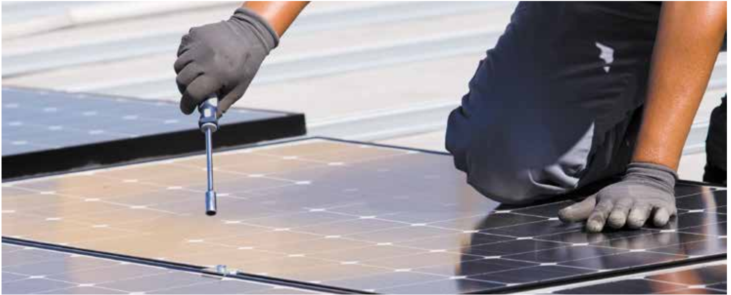
Das neue Energiegesetz wird der Produktion von Solarstrom starken Auftrieb verleihen (Foto: istockphoto.com).
