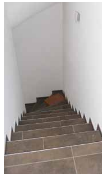
Brauche ich hier einen Handlauf?
