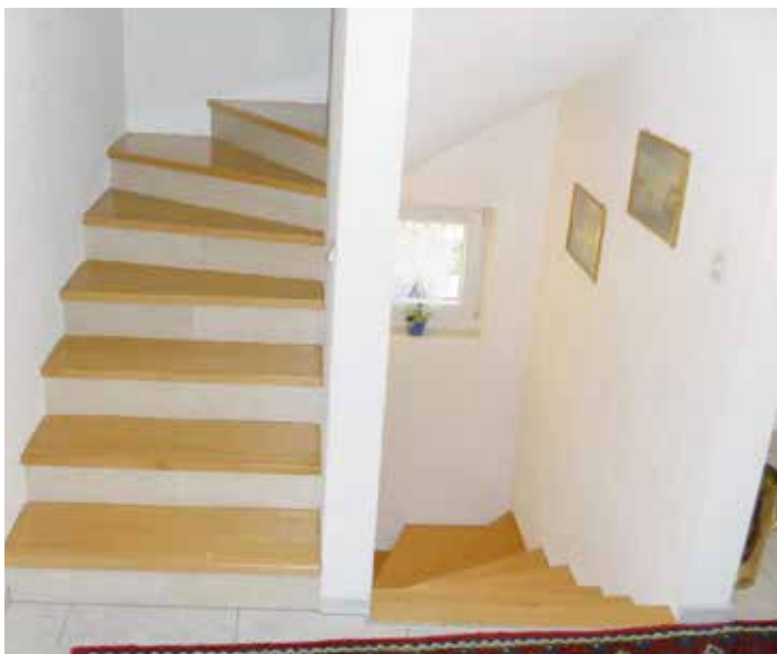
Muss ich hier einen Handlauf nachrüsten?
