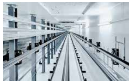
Liftschacht im Prime Tower, Zürich
