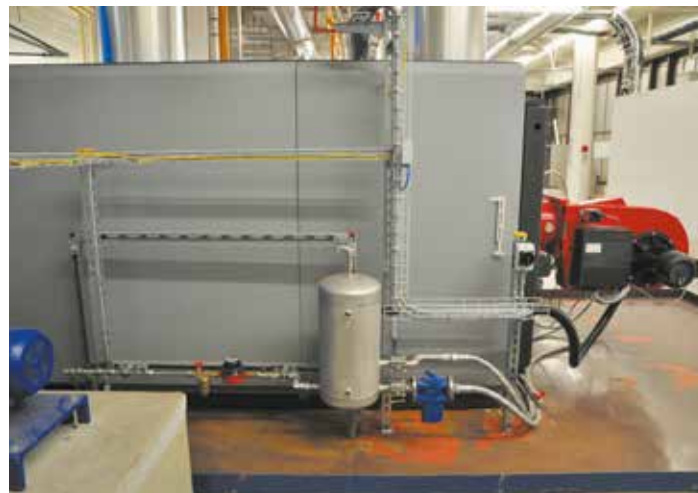
Zwei Weishaupt Zweistoff Brenner RGL 40 multiflam für Öl und Gas ersetzen die drei alten Brenner.
