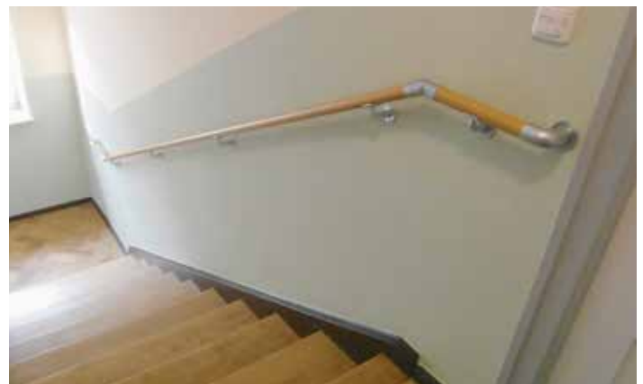
Handlauf in einer Wohnanlage mit Knick nach Norm hier in Buche hell.
