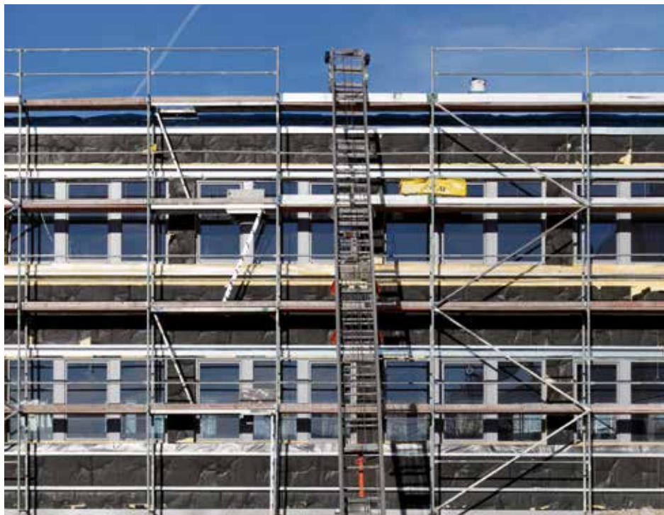
Bauschäden sind nicht immer eine Folge von Pfusch, sondern von mangelnder Erfahrung mit neuen Techniken und Materialien (Foto: view7 / photocase.de).
