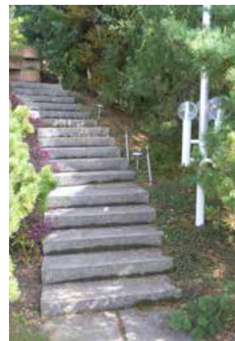
Fehlt hier ein Handlauf?
