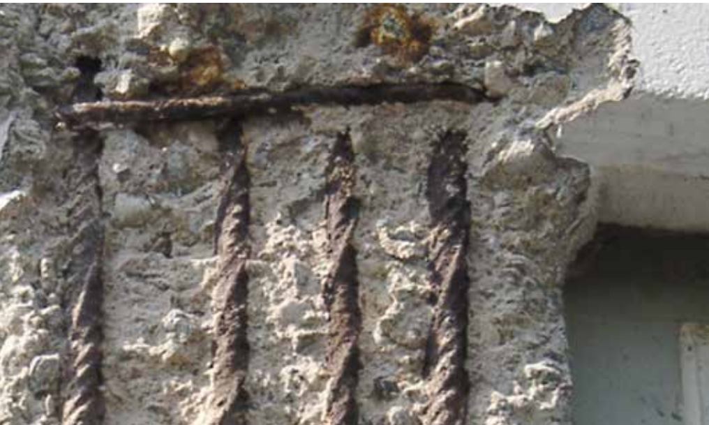
Im Schweizer Hochbau wurden 2011 rund 21 Mrd. CHF verbaut. Davon mussten 1,6 Mrd. CHF in die Mängelbehebung investiert werden.
