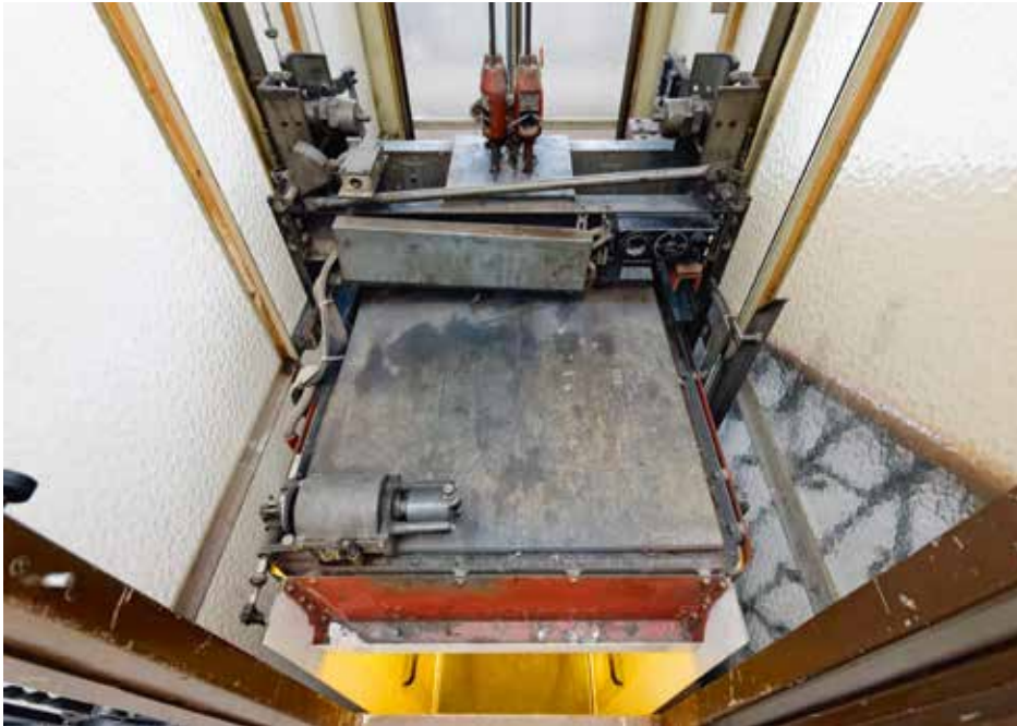
Alte Aufzüge erfüllen die heutigen Sicherheitsanforderungen oft nicht (Foto: Remy Steinegger).
