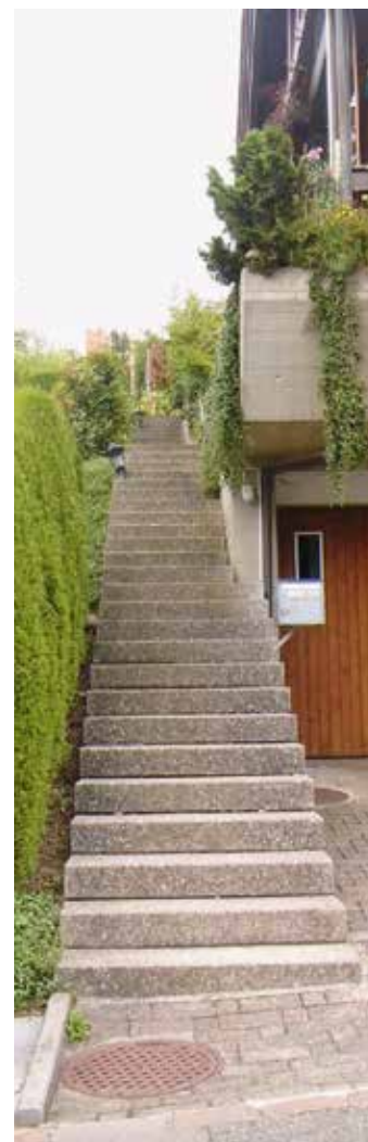
Im Schadensfall wird die Versicherung hier wohl die Haftung ablehnen, und der Bauherr oder Eigentümer haftet.
