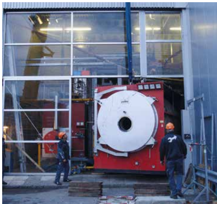
Man sieht, wie eng das war: Ausbringen des alten Weber-Kessels aus der Rivella-Heizzentrale
