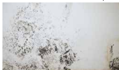
Schimmelbefall in einer Altbauwohnung.
