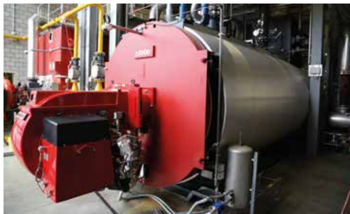
Der neue astebo-5 MW-Heisswasserkessel mit Weishaupt-Zweistoffbrenner Fotos: Rivella/photopress
