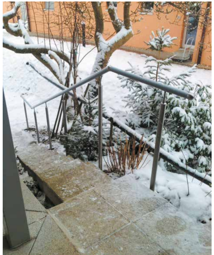
Bei schmalen Treppen müssen die Stützen neben der Treppe befestigt sein, damit der Nutzer sicher auf der Treppe laufen kann.
