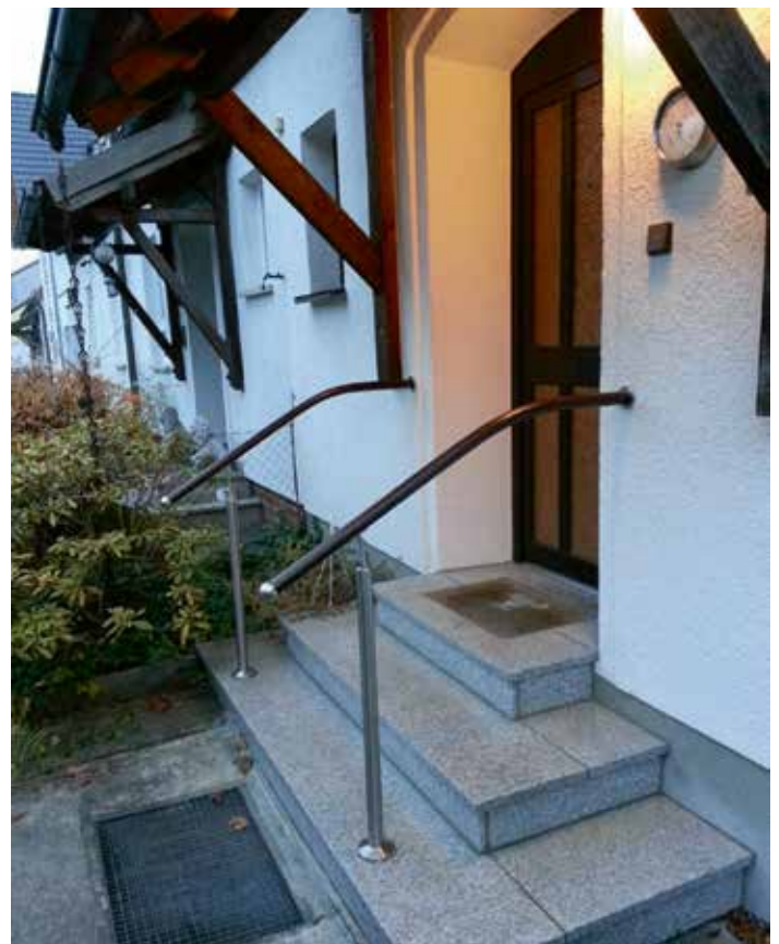
Auch wenige Stufen brauchen einen Handlauf- hier handwarmes Aluminium mit Laminat
