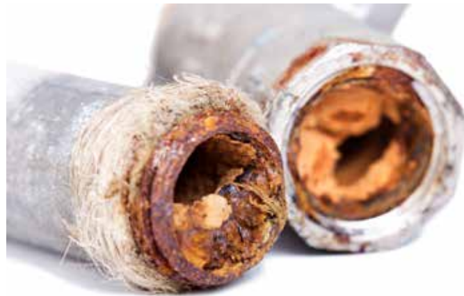
verkalkte und verrostete Rohre
