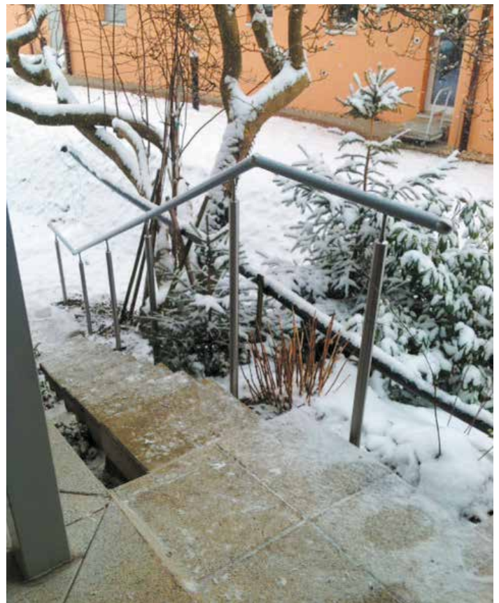
Bei schmalen Treppen müssen die Stützen neben der Treppe befestigt sein, damit der Nutzer sicher auf der Treppe laufen kann.
