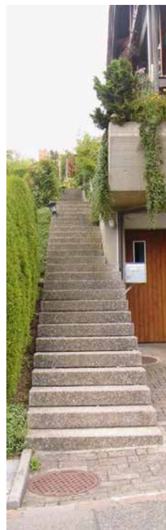
Im Schadensfall wird die Versicherung hier wohl die Haftung ablehnen, und der Bauherr oder Eigentümer haftet.
