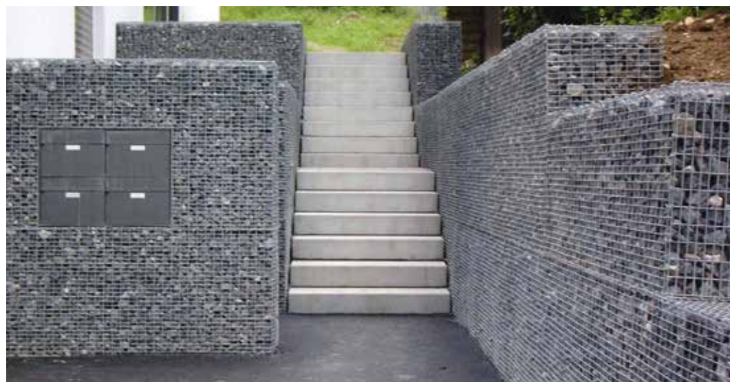
Hier haftet unstrittig im Schadensfall der Eigentümer oder die Stockwerkeigentümergeinschaft
