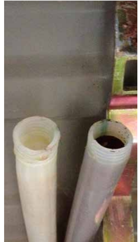
Der Unterschied von gereinigt und unge-reinigt ist frappant und macht sich auch bei der Heizkostenabrechnung bemerkbar.
