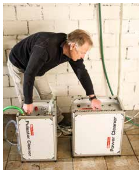
Der Spülcomputer bereitet das Wasser auf, mit welchem das Heizsystem gespült wird. Der Pulsator speist das aufbereitete Spülwasser pulsierend ins Heizsystem ein.
