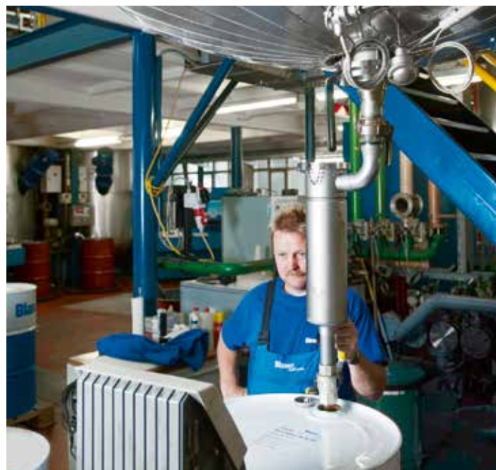
Der neue Thermoölkessel mit modulierendem Weishaupt-Gasgebläsebrenner
