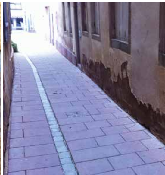
Der Aussenputz wurde im Sockelbereich durch aufsteigende Feuchte zerstört.
