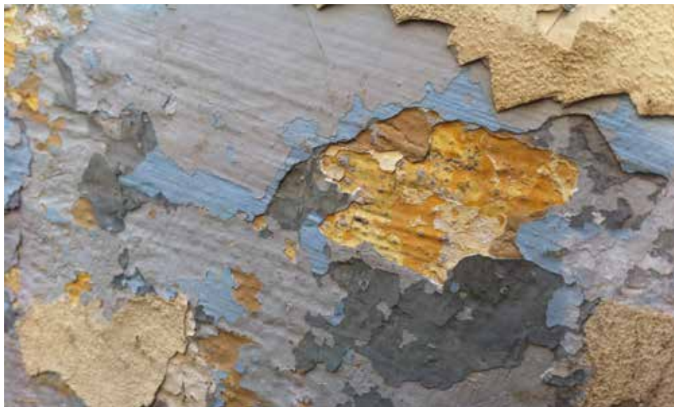
Abplatzungen am Fassadenputz, die durch zu viele übereinanderliegende Schichten entstanden sind.
