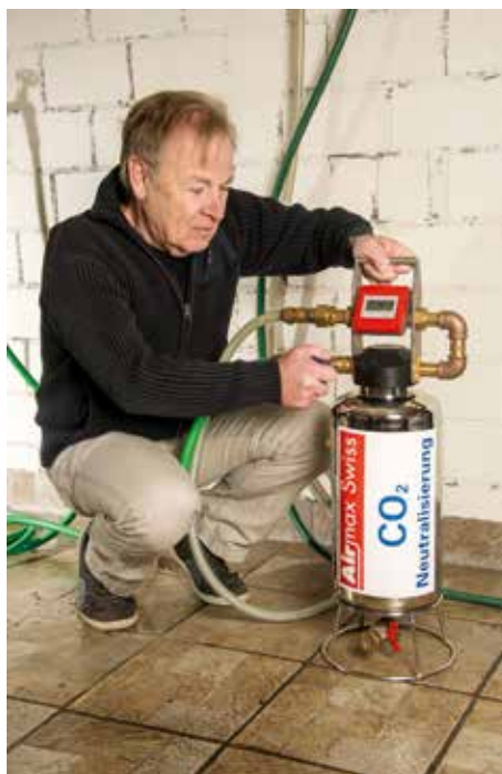
Nach der Reinigung wird das Heizsystem mit CO 2 -neutralisiertem Wasser nach SWKI-Norm gefüllt.
