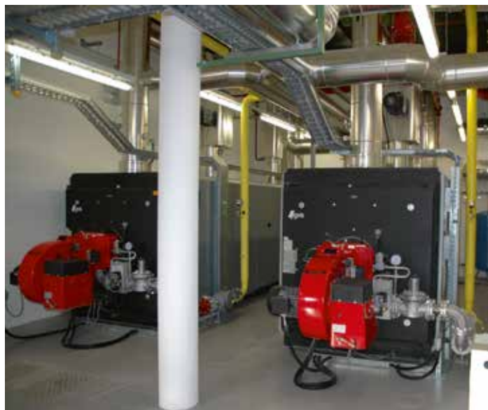
Die beiden neuen 2,15 MW-Kessel mit Weishaupt-Gas-Gebläsebrennern
