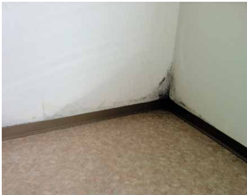
Schimmelbildung in einer Zimmerecke durch eine Kältebrücke an der Aussenwand.
