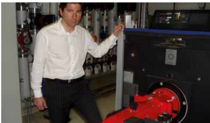
Direktor Thomas Vogt ist begeistert. Die sanierte Ölheizung leistet einen grossen Anteil an das vereinbarte Energiesparziel. Foto: K. Rügegg
