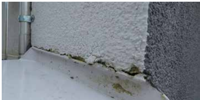
Schlecht ausgeführt: Die Bewegung der Fensterbank zerstört die Fassadenkonstruktion (Quelle: QS Fassaden GmbH).
