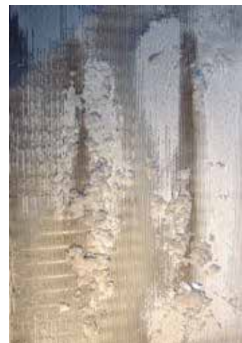
Massiv erhöhter Energieverbrauch durch völlig verstopfte Lüftungssysteme, verschmutzte Ventilatoren und Kühlbatterien ohne Luftdurchlass.
