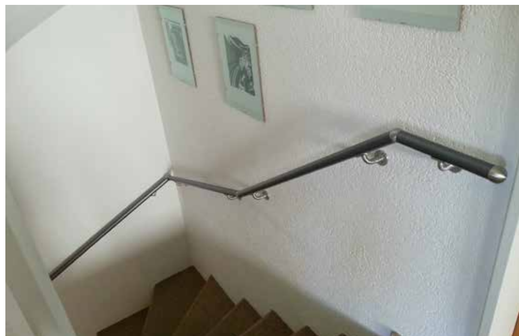
Durchlaufender Handlauf wandseitig mit Kugelverbindungen
