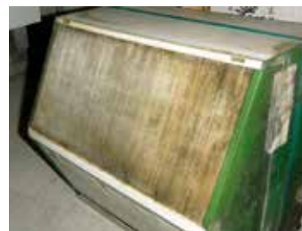
Wärmetauscher in ungutem Zustand
