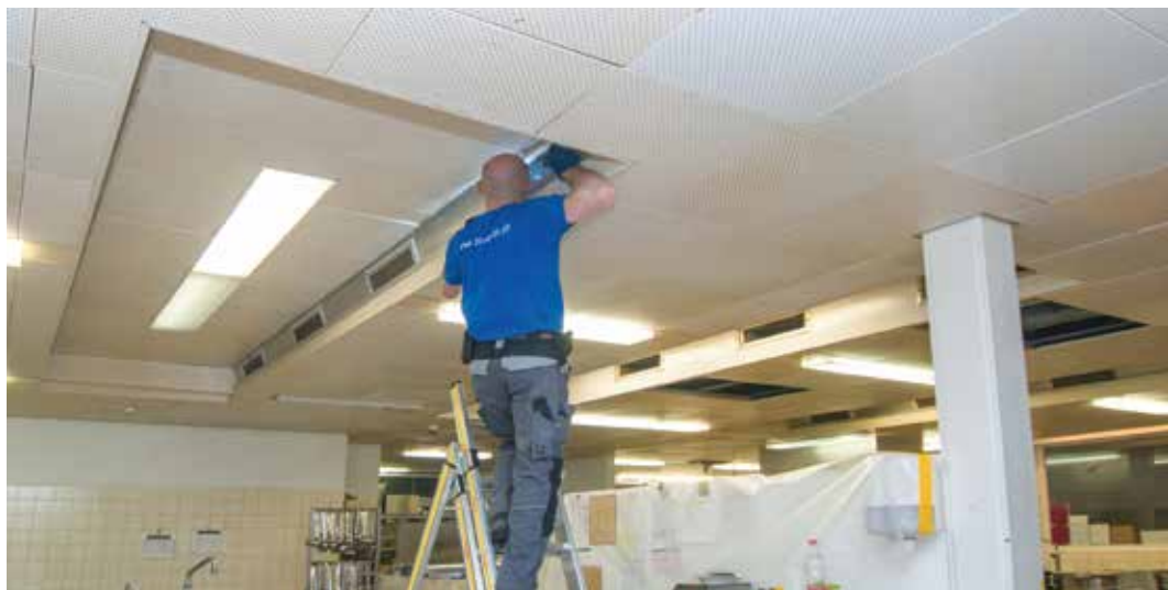
Beispiel Küche: Nach dem Entfernen aller Abluftgitter werden die verfetteten Kanäle mit speziellen Werkzeugen und hauseigenen Reinigungsmitteln gemäss Stand der Technik gereinigt. Die Gitter werden separat gereinigt, Schrauben ersetzt.
