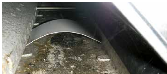
Lüftungsboden überzogen von Schimmel, Schmutz und Staub.
