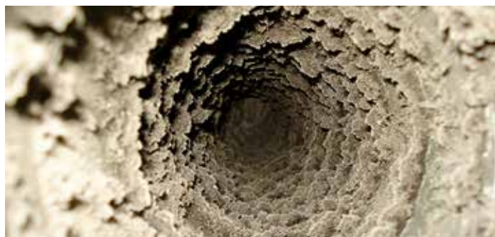
Verschmutzte Lüftungsrohre sind nicht allein unhygienisch, im Brandfall können sich die Ablagerungen entzünden.
