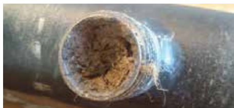
Der Sauerstoffeintritt begünstigt die Schlamm- bildung in den Heizschlangen und verstopft diese.
