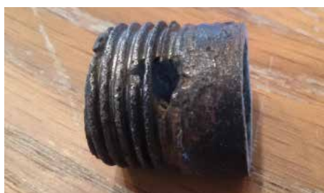
Das Eindringen von Sauerstoff fördert die Rostbildung in Steigleitungen und Heizverteilern.
