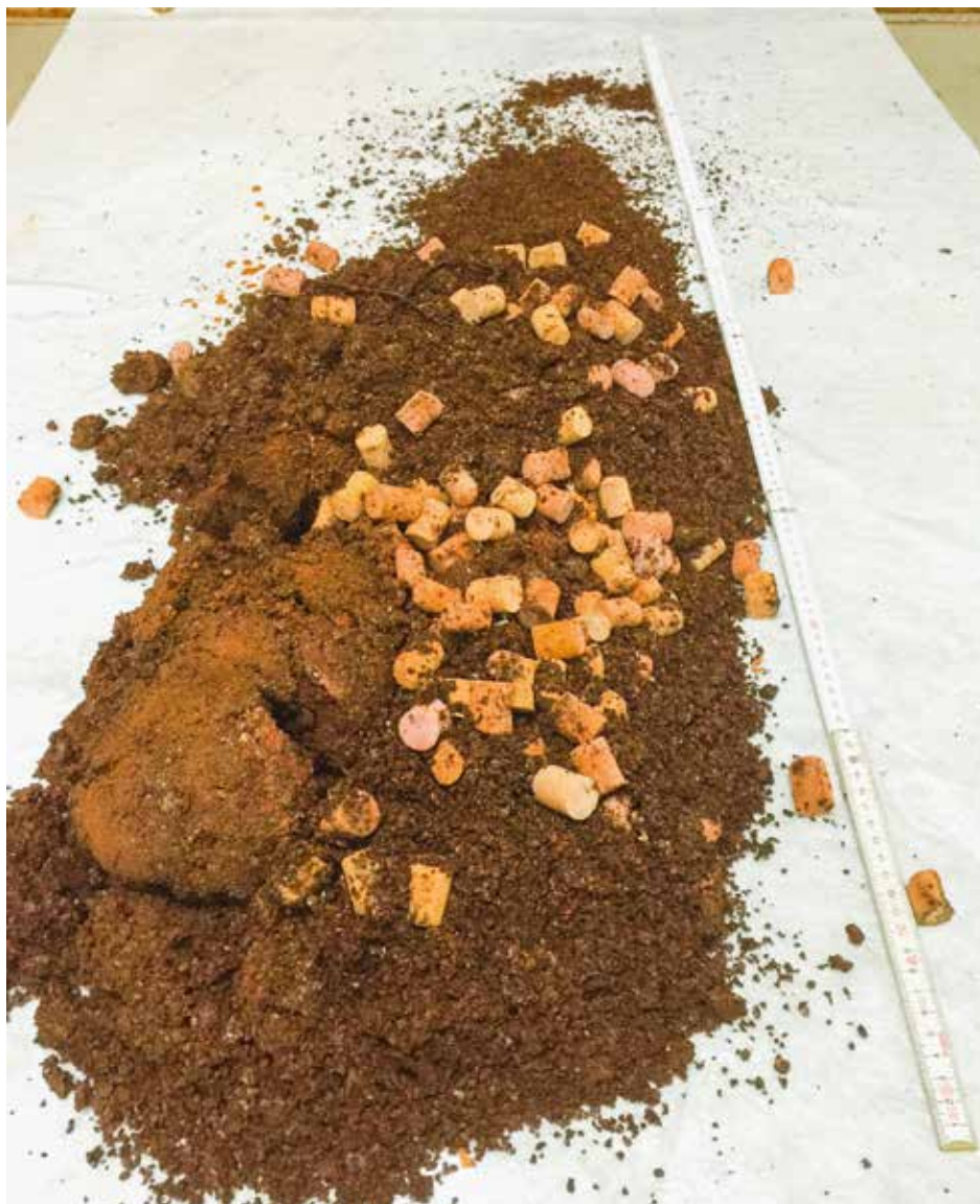
Diese Menge an Rückständen (inklusive der dafür benutzten Schaumstoff-Laufkörper) wurden aus den Rohren eines Einfamilienhauses gelöst.
