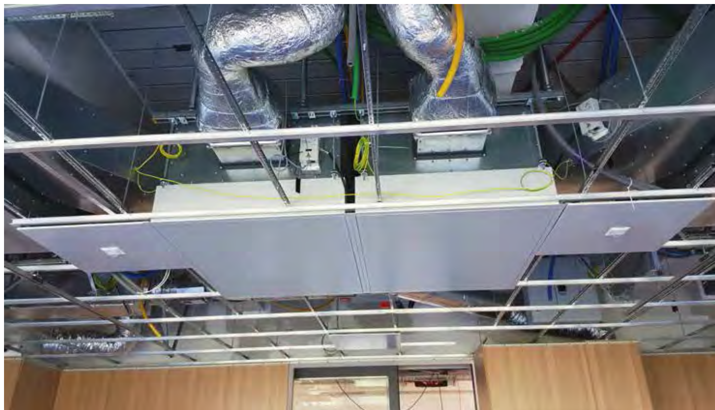
Luftauslässe in einem Isolierraum
