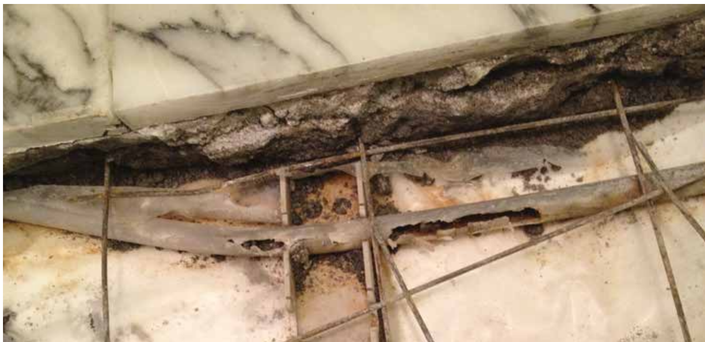
Bild eines versprödeten und lecken Bodenheizungsrohrs.
