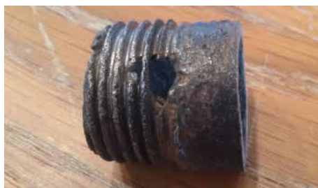
Das Eindringen von Sauerstoff fördert die Rostbildung in Steigleitungen und Heizverteilern.
