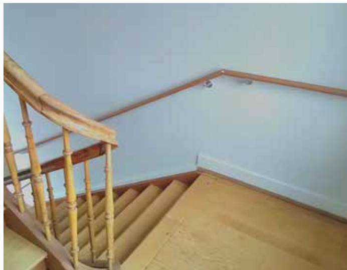
wandseitig nachgerüstet in einer Wohnbaugenossenschaft, Altbestand
