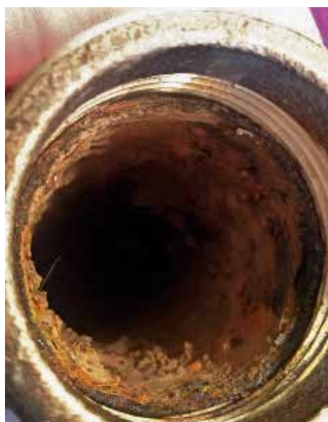
Der Prozess der Schlamm- bildung ist schleichend.
