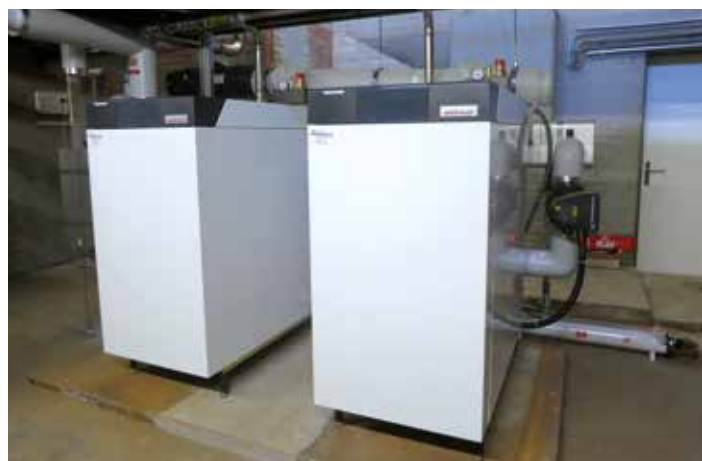
Gasbrennwert Kessel in zweier Kaskade mit Total 580 kW Leistung von Weishaupt mit hoher Effizienz, Funktionalität und kompakter Bauweise
