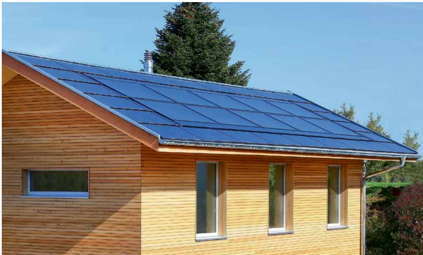
Hier bilden die PV-Module sozusagen den Rahmen für die Sonnenkollektoren: eine Variante, die vielen Hausbesitzern gefällt. Denkbar sind aber auch andere Kombinationen.
