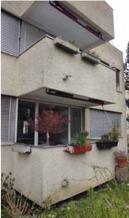
Auch die Balkons waren renovationsbedürftig.
