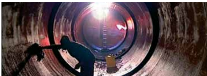
Ein revidierter Tank erhöht die Betriebssicherheit und trägt zum Werterhalt der Heizungsanlage bei.
