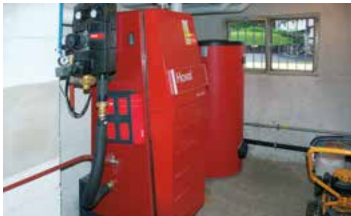
Die neue Brennwert-Gasheizung, dahinter der 400 Liter- Warmwasser-Kombispeicher.
