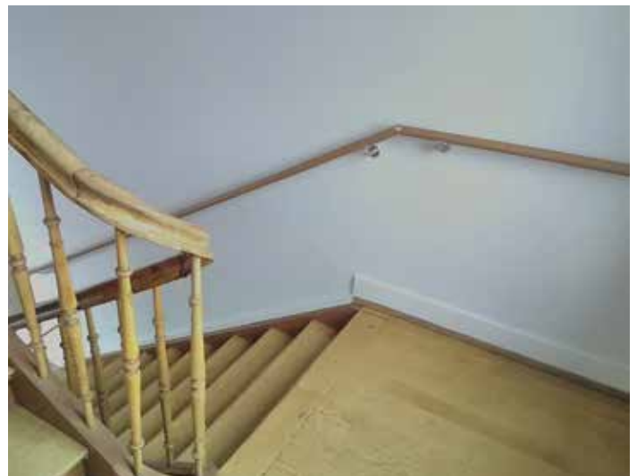
wandseitig nachgerüstet in einer Wohnbaugenossenschaft, Altbestand
