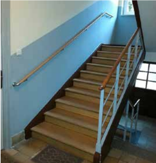
Genossenschaftliche Wohnanlage mit dem wandseitigen Handlauf nachgerüstet, Austritt mit Knick nach Norm.
