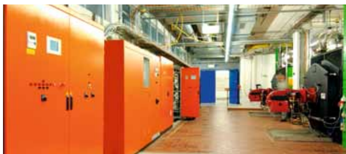
Sanierung Triemli: Heisswasserzentrale mit zwei multiflam®-Zweistoffbrennern RGL40/2-A 3LN mit Feuerungsmanager. Links im Bild die übergeordnete Leittechnik, die mit dem WH-Feuerungsmanager verbunden ist.
