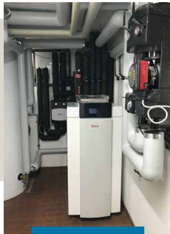
Beispiel einer Ölheizungsanlage mit Brenner und Boiler. BILD: ZVG
